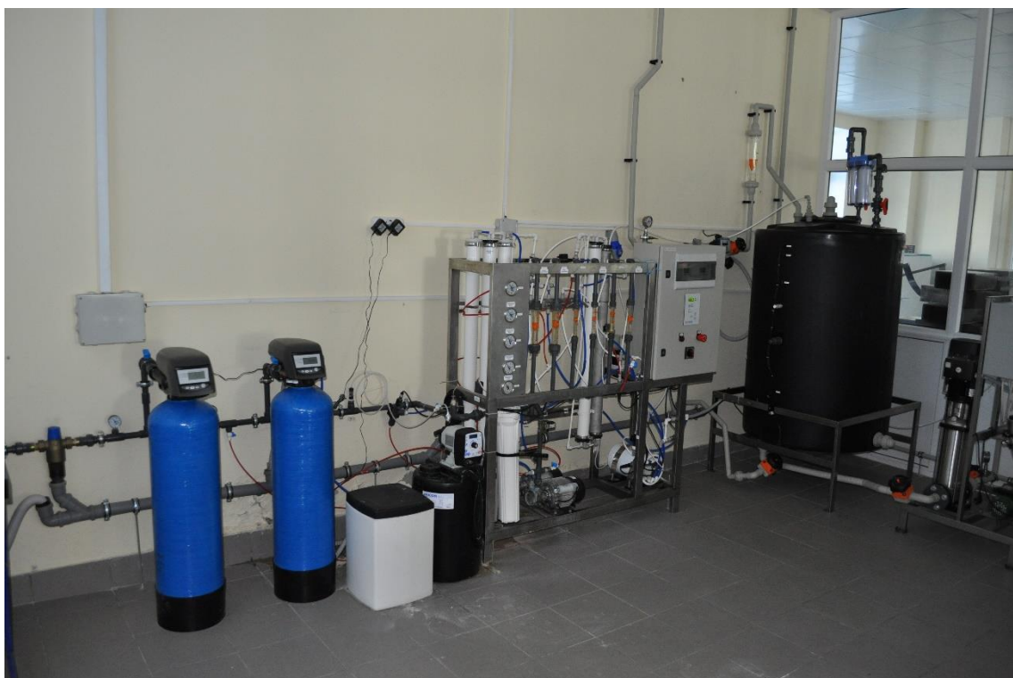
Рис. 85. Оборудование для водоподготовки
